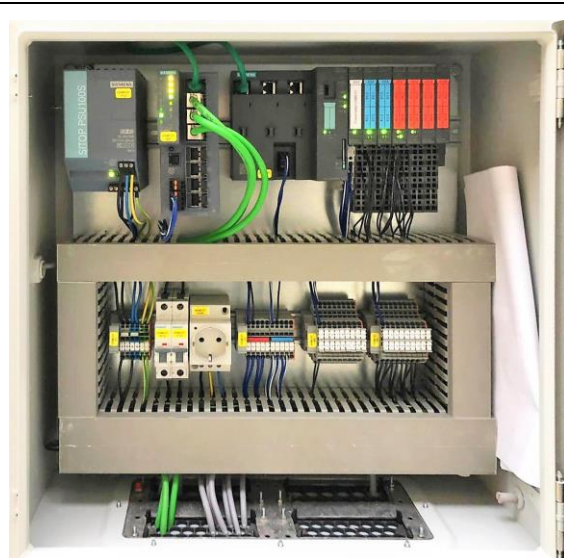
Abbildung 4: Schaltschrank mit Steuerung der Anlage
